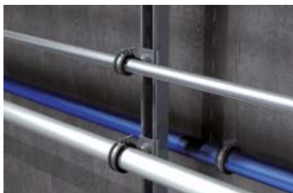
Szerelősínre szerelt csővezeték
